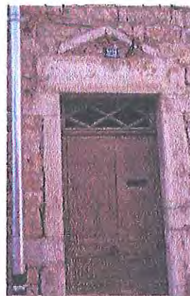
l'arc de décharge au-dessus de l'encadrement est fonctionnel et doit être recouvert d'enduit
