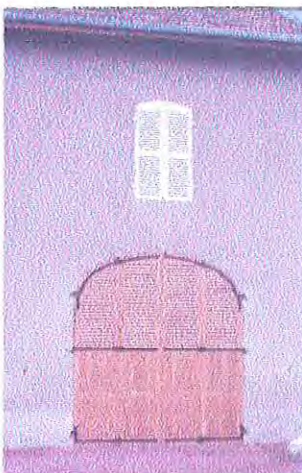
La grange devient garage : le traitement de la porte, avec des portes pleines en partie basse, et des volets à persiennes en partie haute, permet de conserver l'image générale de la porte de grange tout en étant très fonctionnel.
