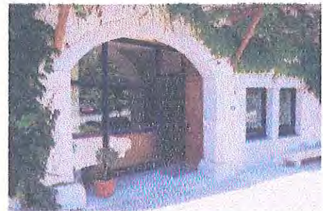
la nouvelle menuiserie s'écarte de la façade pour guider vers l'entrée de la maison et permet l'éclairage du séjour.
